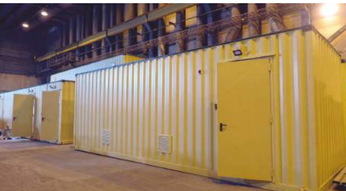
Главная понижающая подстанция (ГПП) 110-10 кВ ФГУП «ГВСУ №4»
