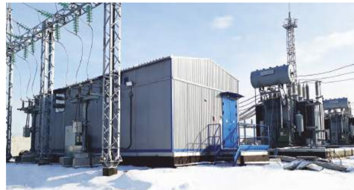
Закрытое распределительное устройство (ЗРУ) 10 кВ Филиал АО «ДРСК» — «Приморские ЭС» ПС «Агрокомплекс» г. Уссурийск
