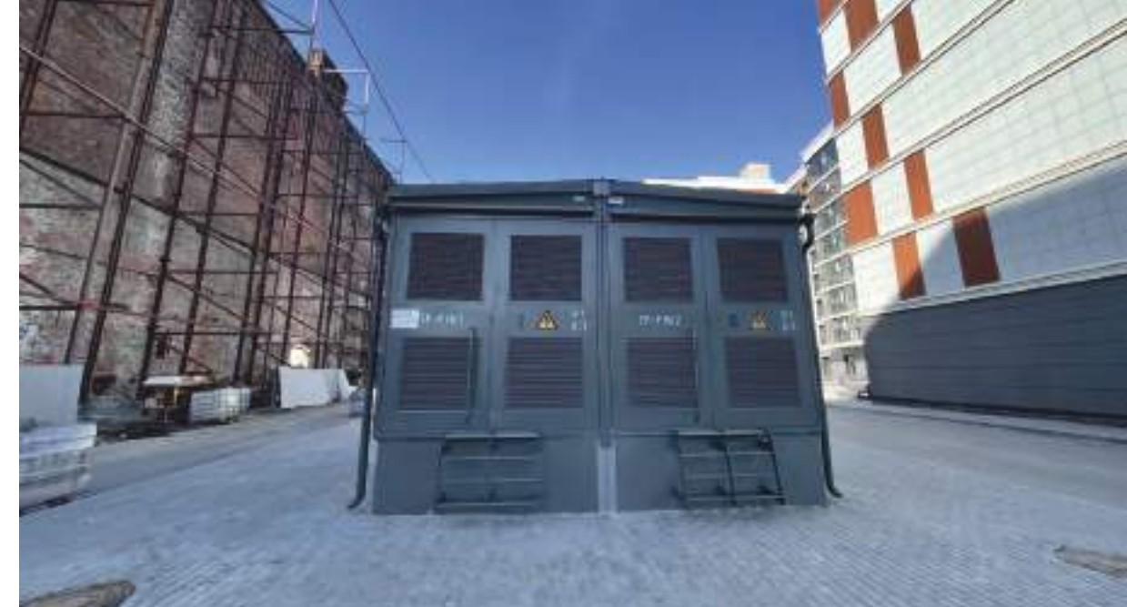
ЗБКТП 10/0,4 кВ 1600 кВА ЖК «Квартал Ше» г. Санкт-Петербург
