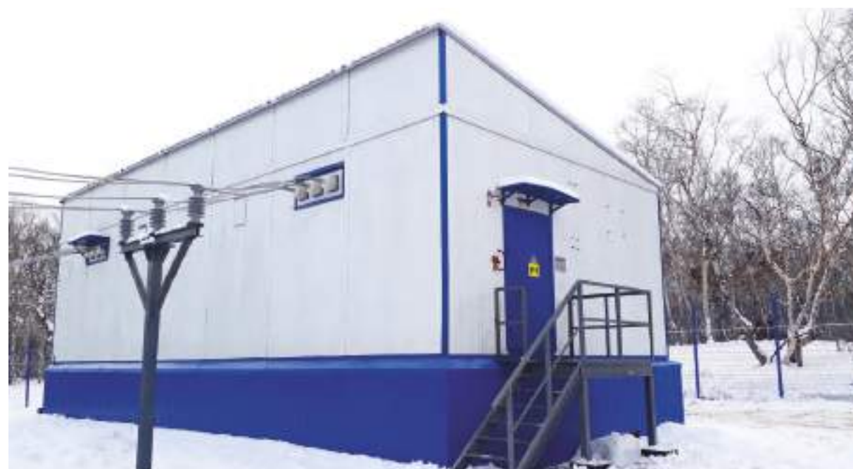
Закрытое распределительное устройство (ЗРУ) 10 и 35 кВ ПАО «Камчатскэнерго» ПС «Туристический Кластер» Камчатский край
