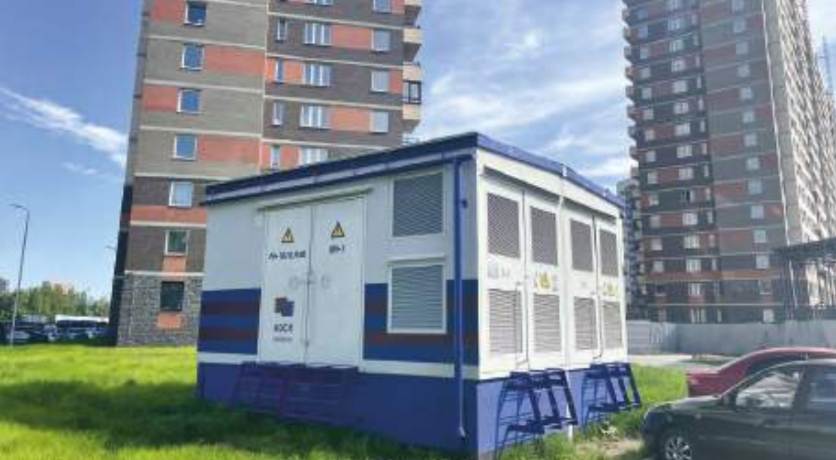
ЗБКТП 10/0,4 кВ 1250 кВА ЖК ЦДС «Северный» г. Мурино
