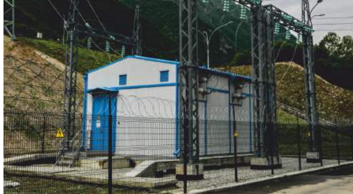
Закрытое распределительное устройство (ЗРУ) 35 кВ ПАО «РусГидро» Верхнебалкарская малая ГЭС, Кабардино-Балкарская Республика
