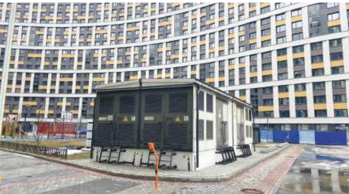
ЗБКТП 10/0,4 кВ 1250 кВА ЖК «Авиатор» г. Мурино
