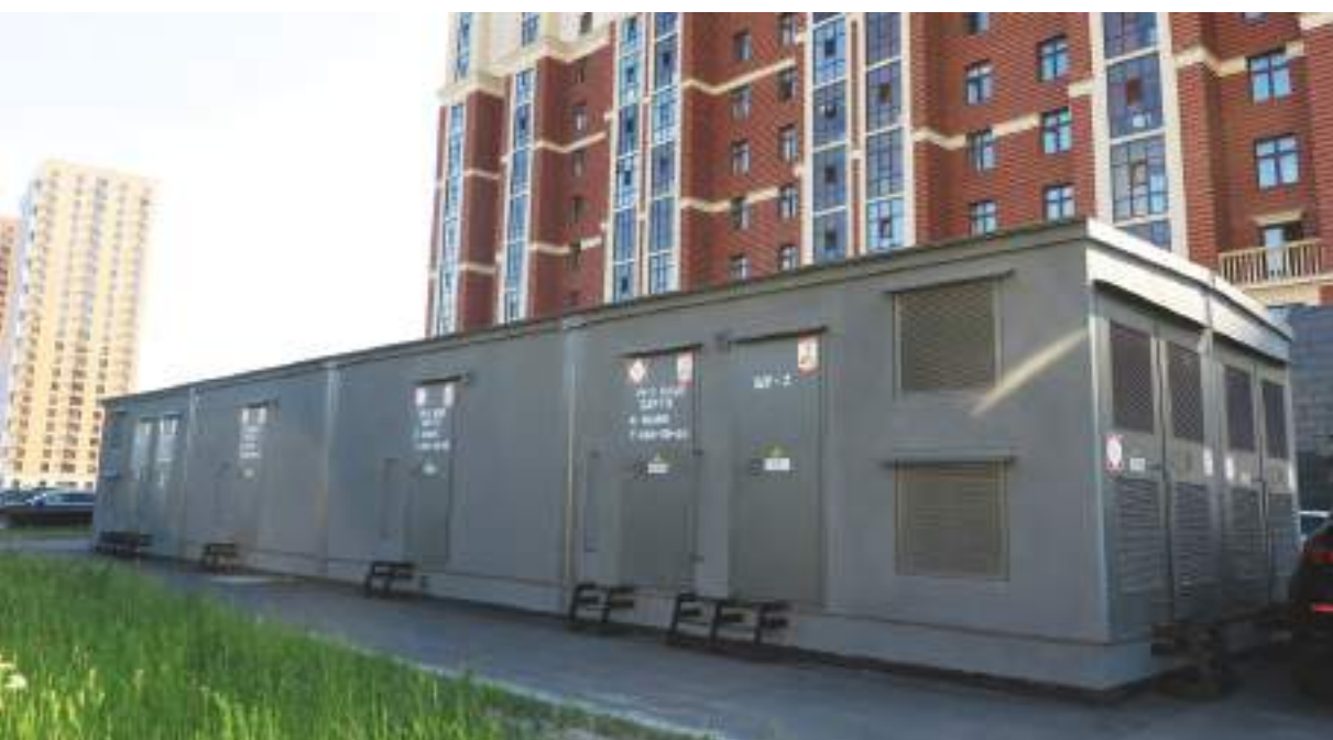
ЗБКРТП 10/0,4 кВ 1250 кВА ЖК «Ренессанс» г. Санкт-Петербург
