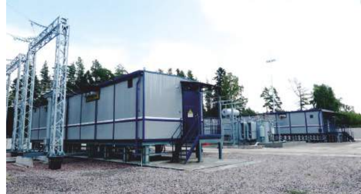
Закрытые распределительные устройства (ЗРУ) 35 и 10 кВ, общеподстанционный пункт управления (ОПУ) ПАО «Россети Ленэнерго» ПС 35 кВ «Бухта» г. Санкт-Петербург
