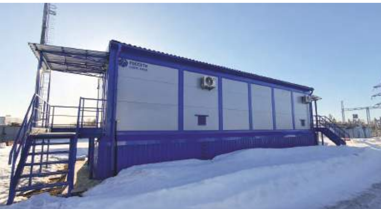
Закрытые распределительные устройства (ЗРУ) 35 и 10 кВ, общеподстанционный пункт управления (ОПУ) Филиал ПАО «МРСК Северо-Запада» — «Вологдаэнерго»
