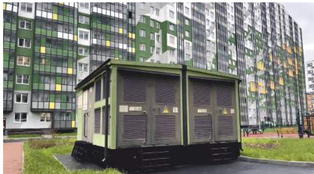
ЗБКТП 10/0,4 кВ 1250 и 1600 кВА ЖК «Мой мир» г. Мурино
