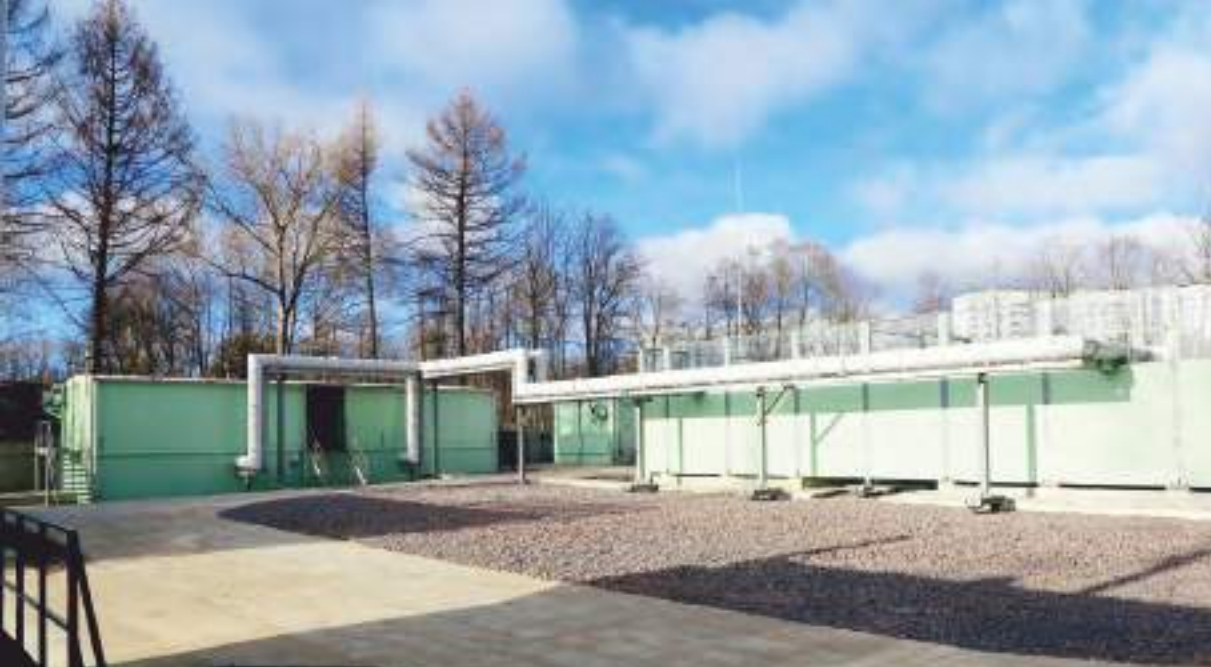
Модульная комплектная трансформаторная подстанция (МКТП) 35/6 кВ ПАО «Россети Ленэнерго» ПС 35 кВ «Осиновая Роща» г. Санкт-Петербург
