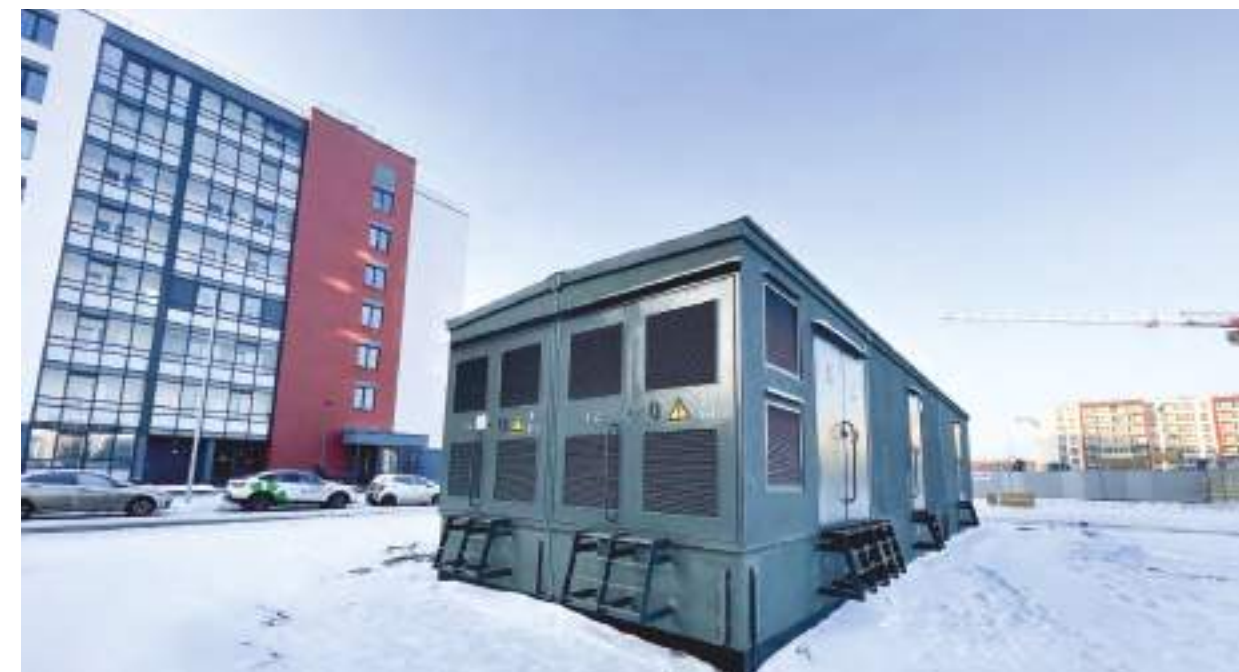
ЗБКРТП 10/0,4 кВ 1000 кВА ЖК «Солнечный город» г. Санкт-Петербург
