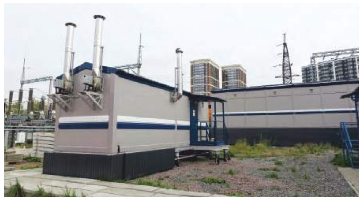
Закрытое распределительное устройство (ЗРУ) 10 и 35 кВ ПАО «Россети Ленэнерго» ПС 110 кВ «Крыловская»
