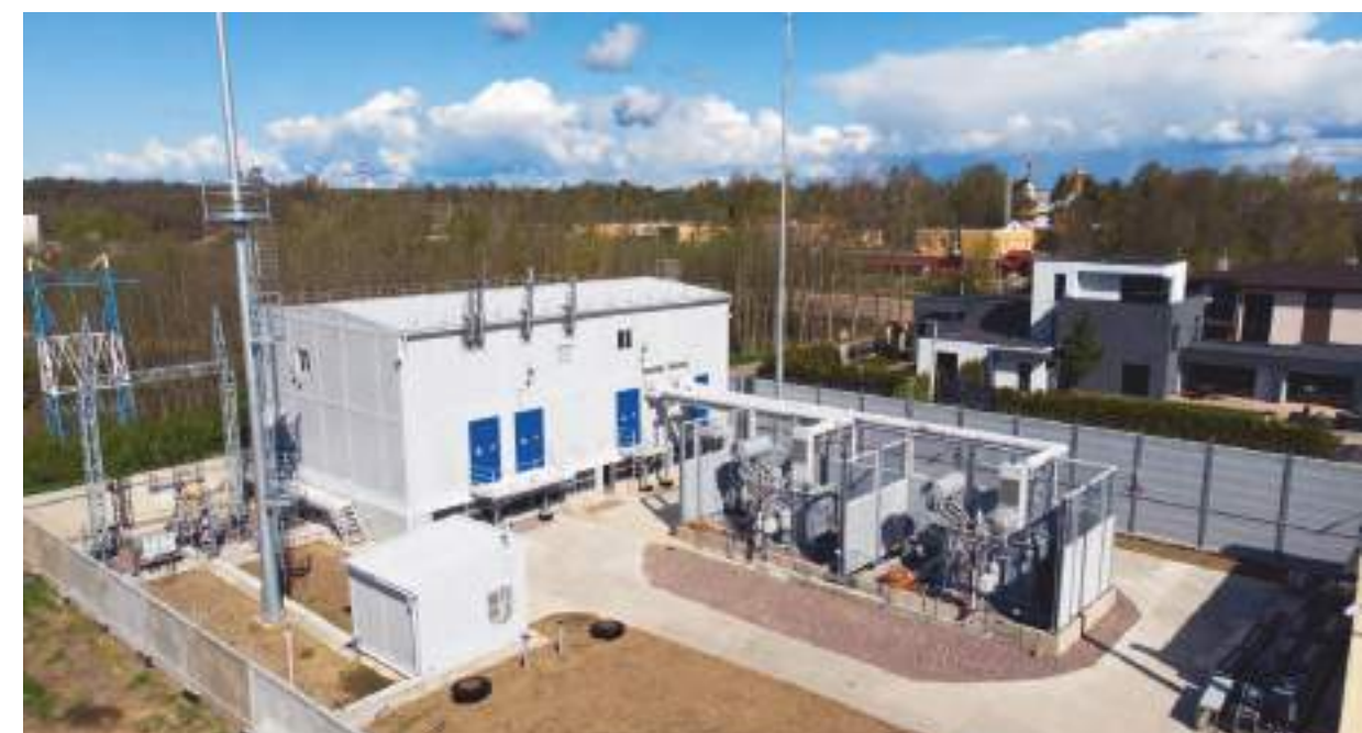
Модульная комплектная трансформаторная подстанция (МКТП) 35/6 кВ ПАО «Россети Ленэнерго» ПС 35 кВ «Ольгино» г. Санкт-Петербург
