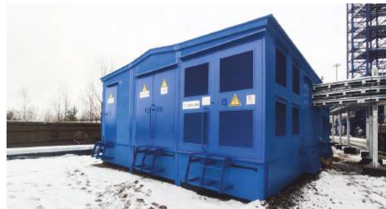
ЗБКРТП 10/0,4 кВ 2500 кВА Угольный терминал ООО «Порт Высоцкий» г. Высоцк
